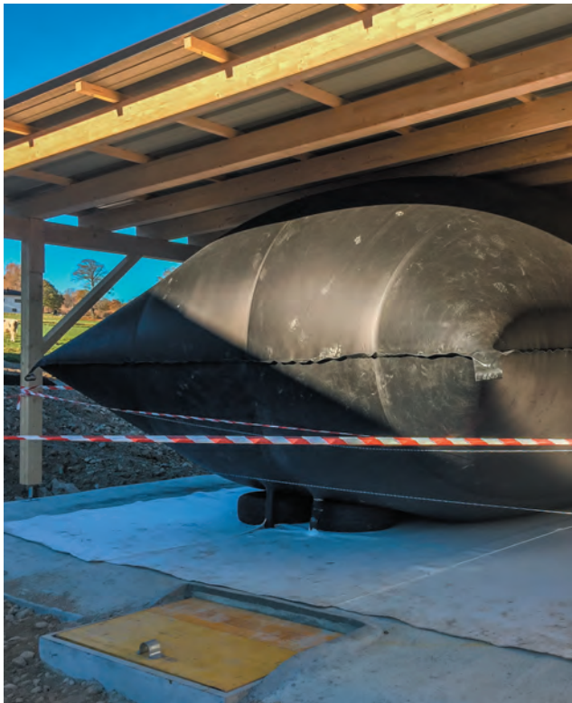
Gasballon unter Dach
